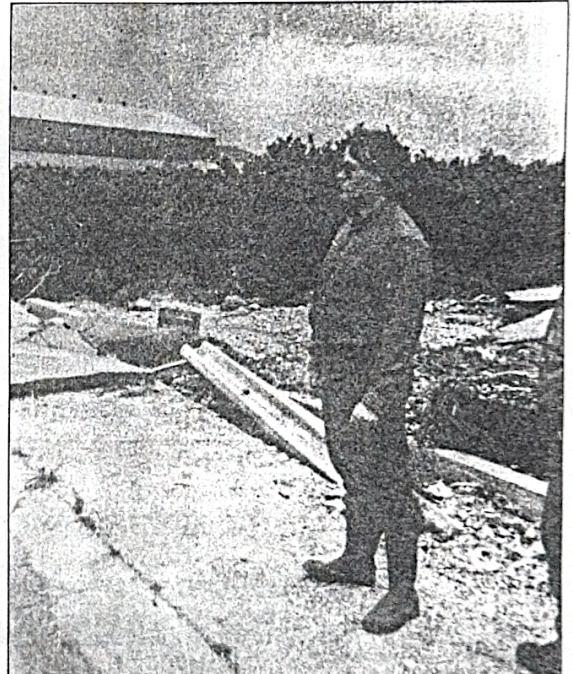
El concejal, Paco Ferrer, del área de Urbanismo, aceptó acompañarnos en nuestro recorrido por los lugares más afectados. En esta fotografía aparece un sector de la carretera de Piles, casi frente al cementerio, donde se había interrumpido el tráfico. Los socavones eran profundos pero quedaban disimulados por el agua que aún los llenaba a raíz de la persistencia de las lluvias hasta este fin de semana.
